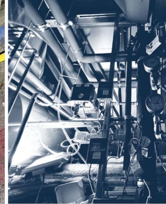
Anlagenhydraulik vor der Fertigstellung
