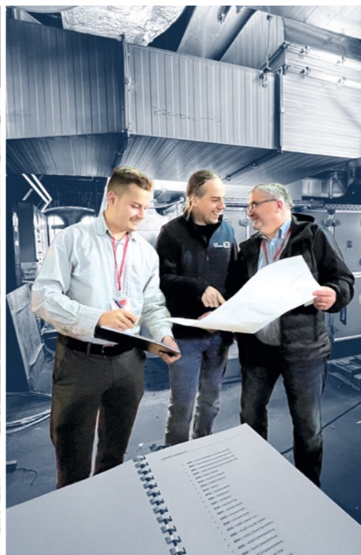
Abnahmetag in der RLT-Zentrale
