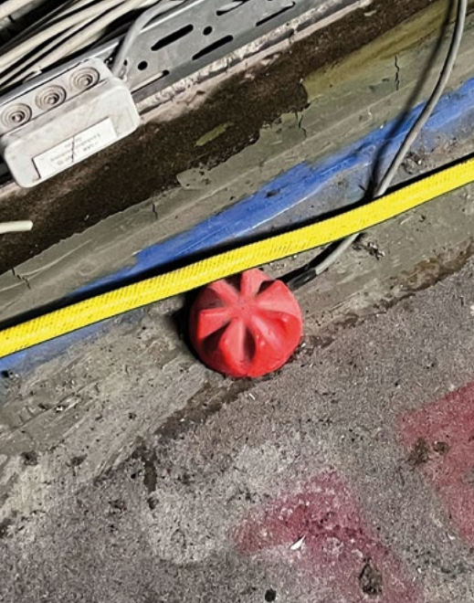
Leckagesensorik zur Risikovorsorge
