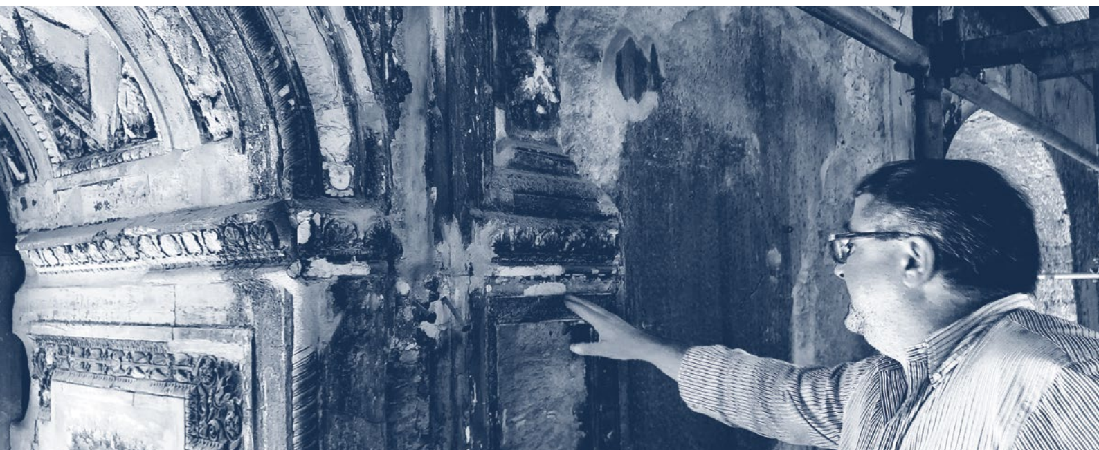
Behutsam gesicherte Bausubstanz mit Brandschäden im Nordflügel des Schlosses
