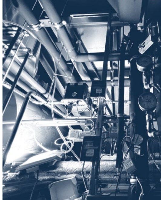
Anlagenhydraulik vor der Fertigstellung
